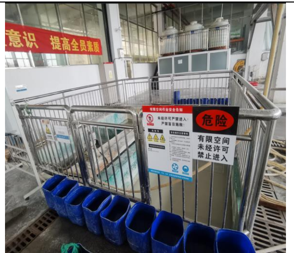
振磨废水沉淀池
