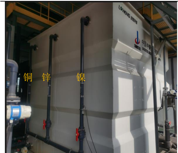
含铜、锌、镍废水处理设施
