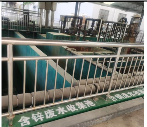
含锌、含铜废水收集池
