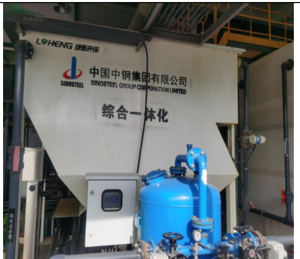
综合废水一体化破乳絮凝沉淀池
